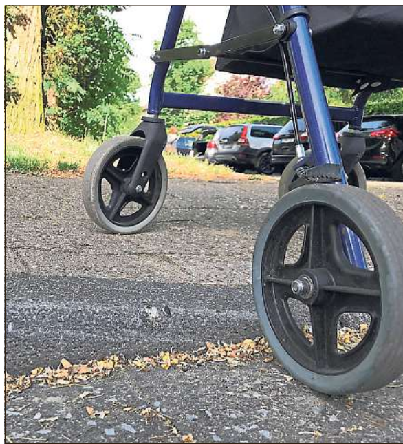
Kanten, die ein Hindernis für Rollatornutzer darstellen, sollen identifiziert werden.
