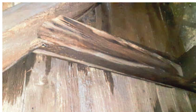
Die Durchfeuchtung am Balken im Kirchturm ist deutlich zu erkennen. Abhilfe soll der Austausch beschädigter Pfannen schaffen.
